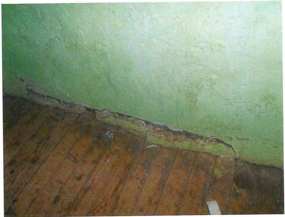
Фото 20. Состояние деревянных полов, зыбкость
