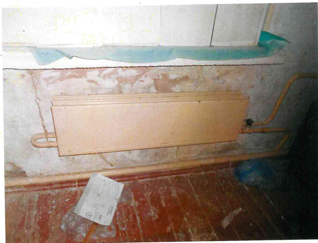
Фото 7. Неудовлетворительное состояние системы теплоснабжения
