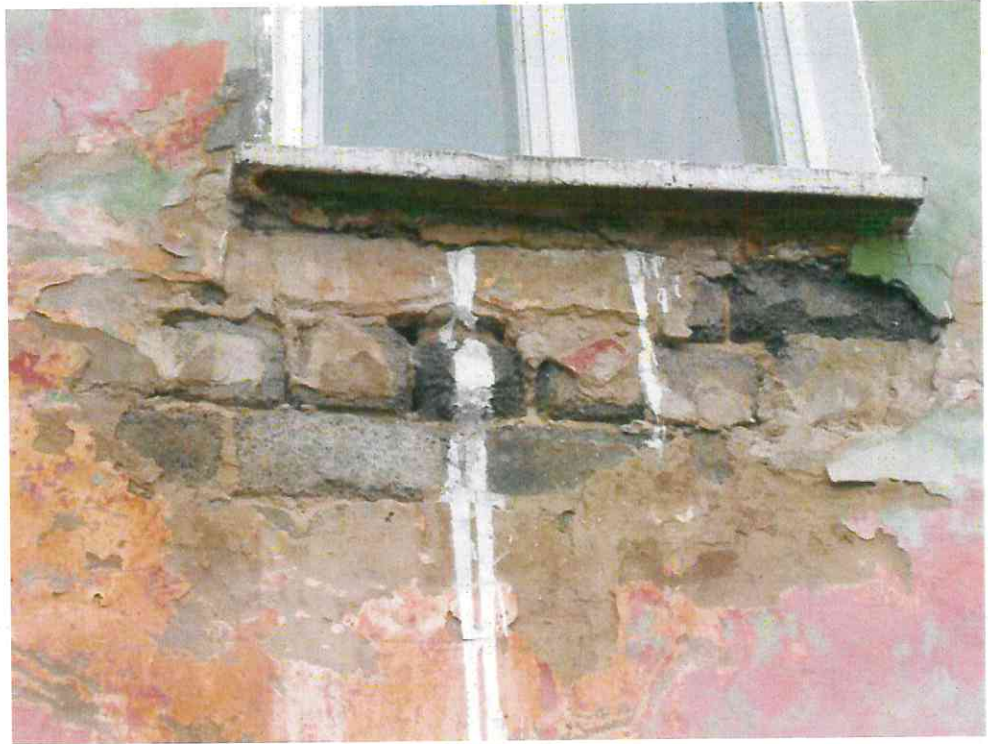
Фото 12. Состояние наружных стен, разрушение штукатурного слоя
