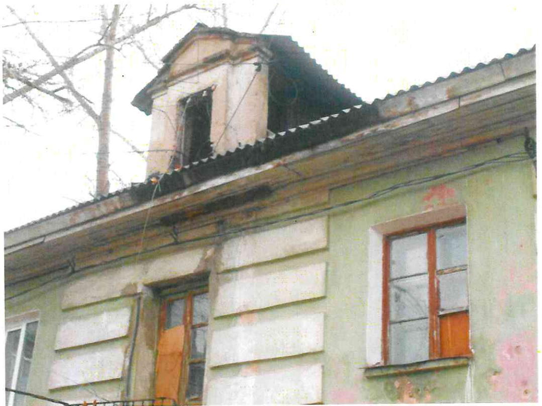
Фото 27. Отсутствие жалюзийных решеток, замачивание карниза
