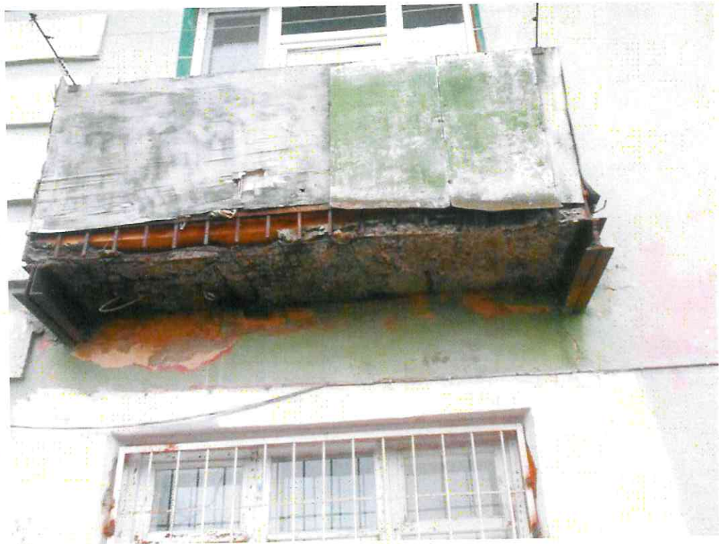
Фото 28. Состояние балконных плит, разрушение железобетонной плиты, коррозия металлических элементов
