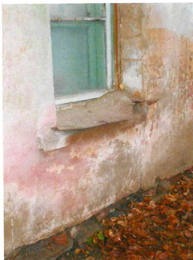
Фото 9. Мелкие трещины в кирпичном цоколе, местные нарушения штукатурного слоя цоколя и стен
