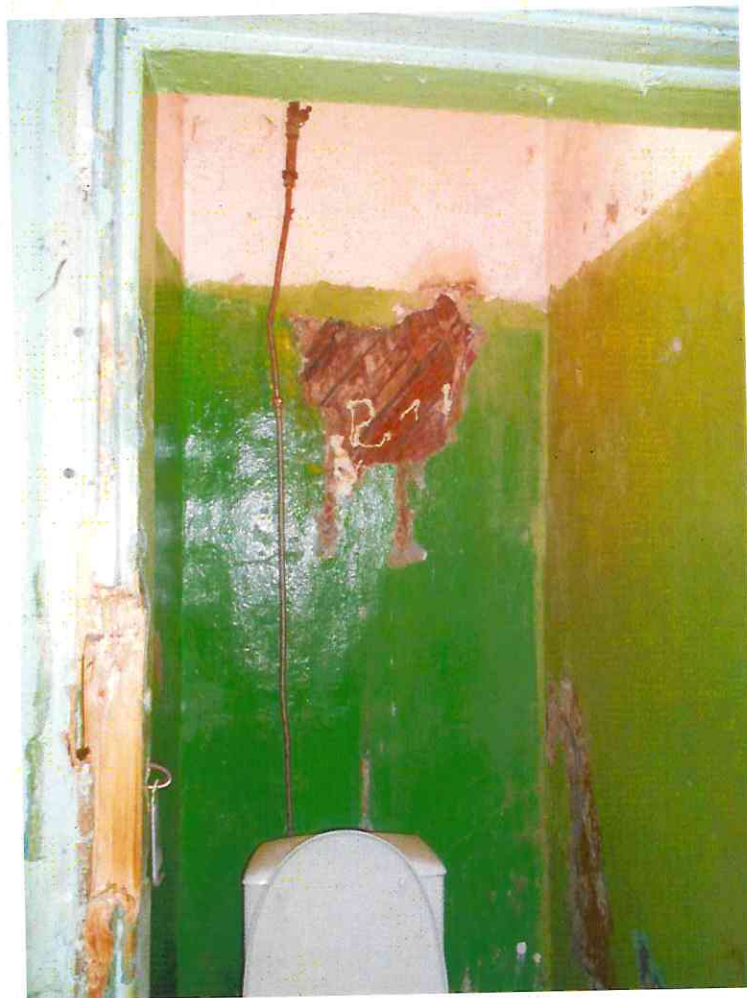
Фото 15. Состояние внутренних стен, оголение drankи, обрушение штукатурного слоя
