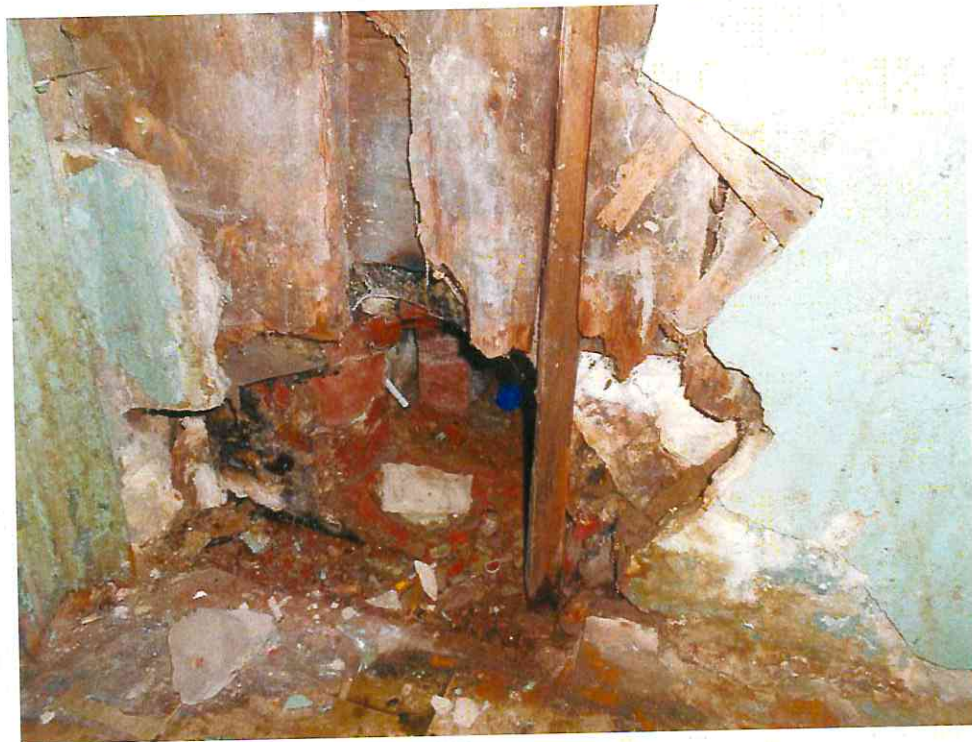
Фото 14. Состояние внутренних деревянных перегородок, разращение, гниль
