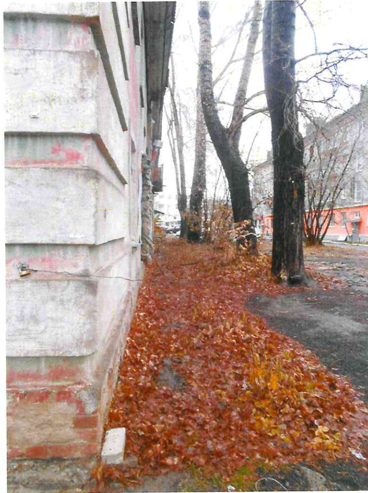
Фото 10. Отсутствие отмостки, провалы грунта по периметру
