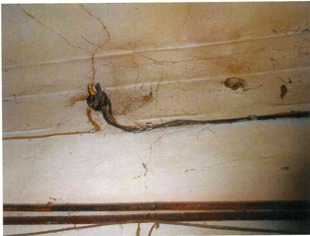
Фото 8. Неудовлетворительное состояние системы электроснабжение, скрутки
