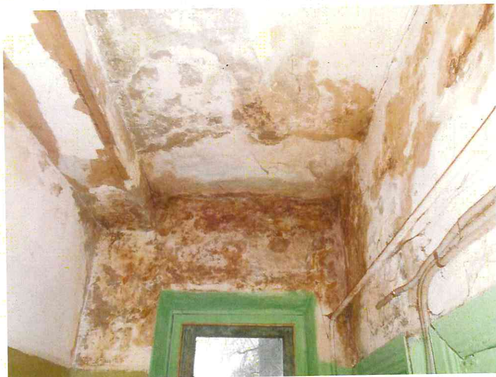
Фото 17. Грибок на стенах в местах общего пользования
