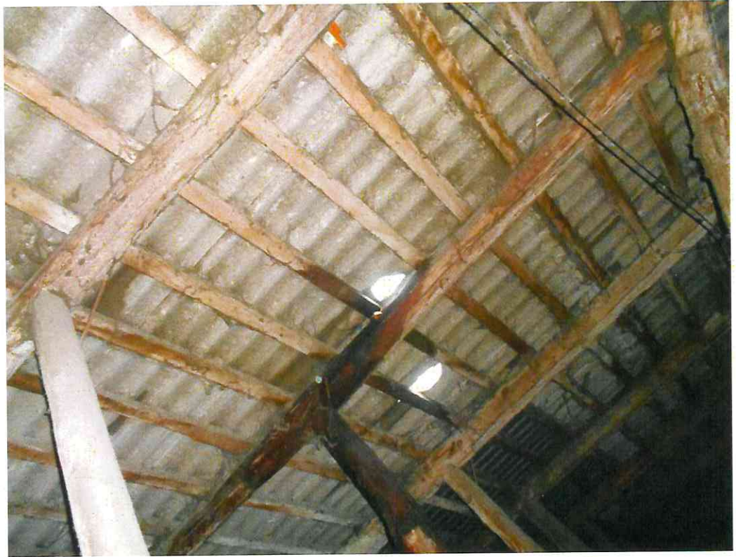
Фото 26. Сквозные дыры, наличие гнили на стропильной системе, повсеместное замачивание
