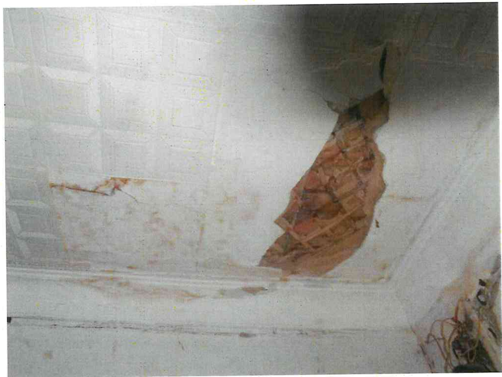
Фото 21. Состояние межэтажного перекрытия, обрушение штукатурного слоя
