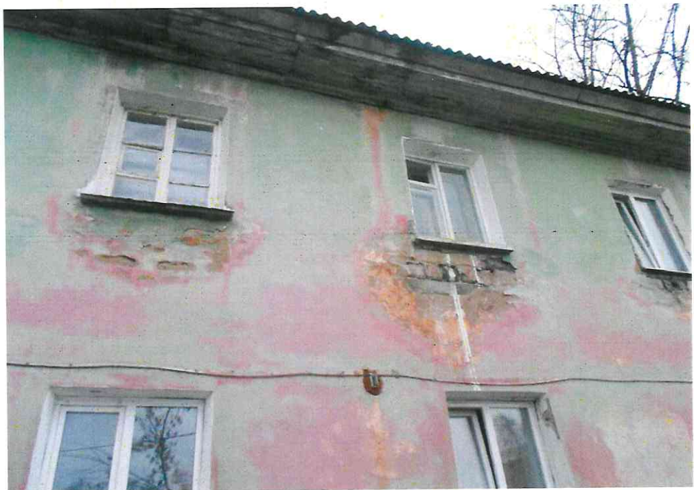
Фото 13. Состояние наружных стен, разрушение штукатурного слоя
