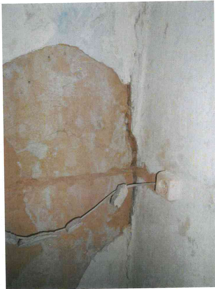
Фото 16. Обрушение штукатурного слоя на стенах.
