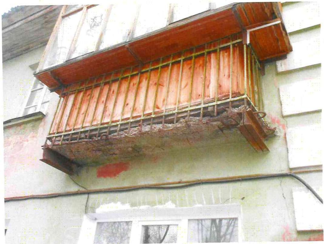
Фото 29. Состояние балконных плит, разрушение железобетонной плиты, коррозия металлических элементов
