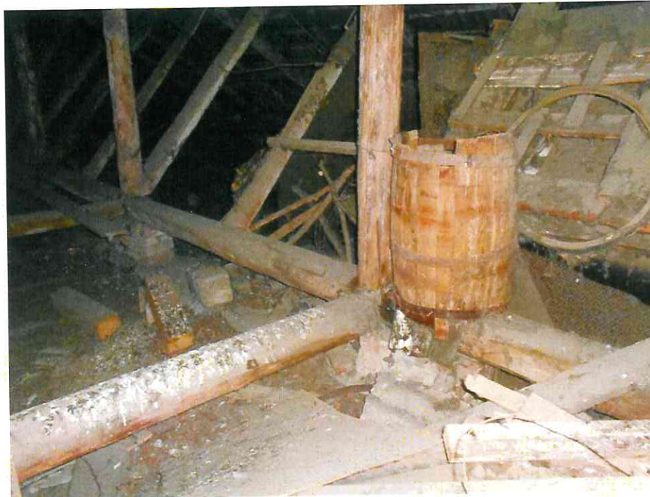
Фото 24. Состояние чердачного помещения, захламленность
