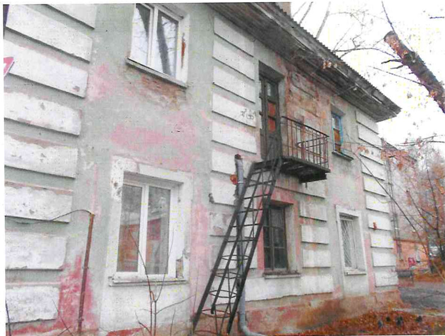
Фото 11. Состояние наружных стен
