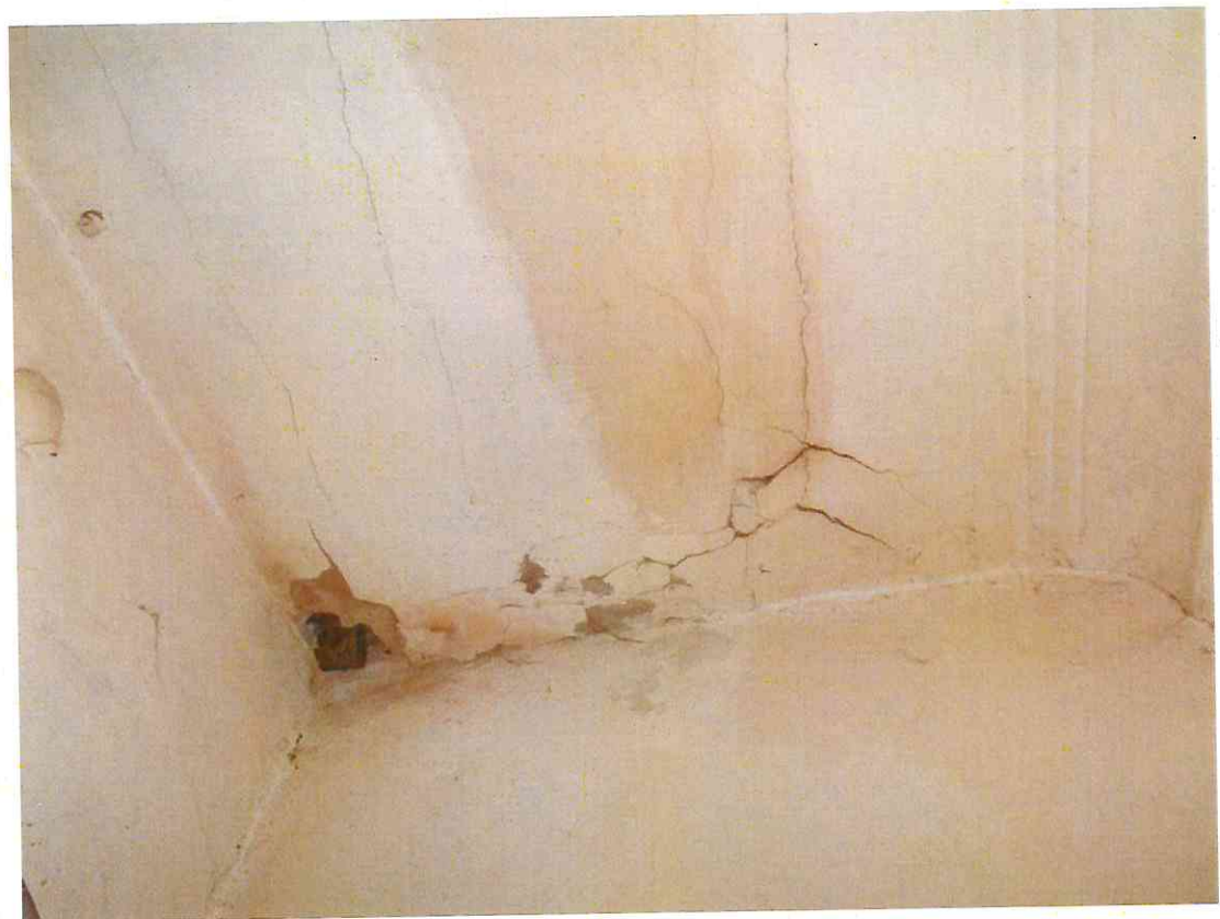
Фото 23. Состояние деревянного перекрытия, множественные трещины, разрушение штукатурного слоя.
