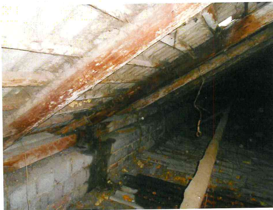
Фото 25. Отколы и трещины шиферного покрытия, сквозные дыры, наличие гнили на стропильной системе, повсеместное замачивание наружных стен
