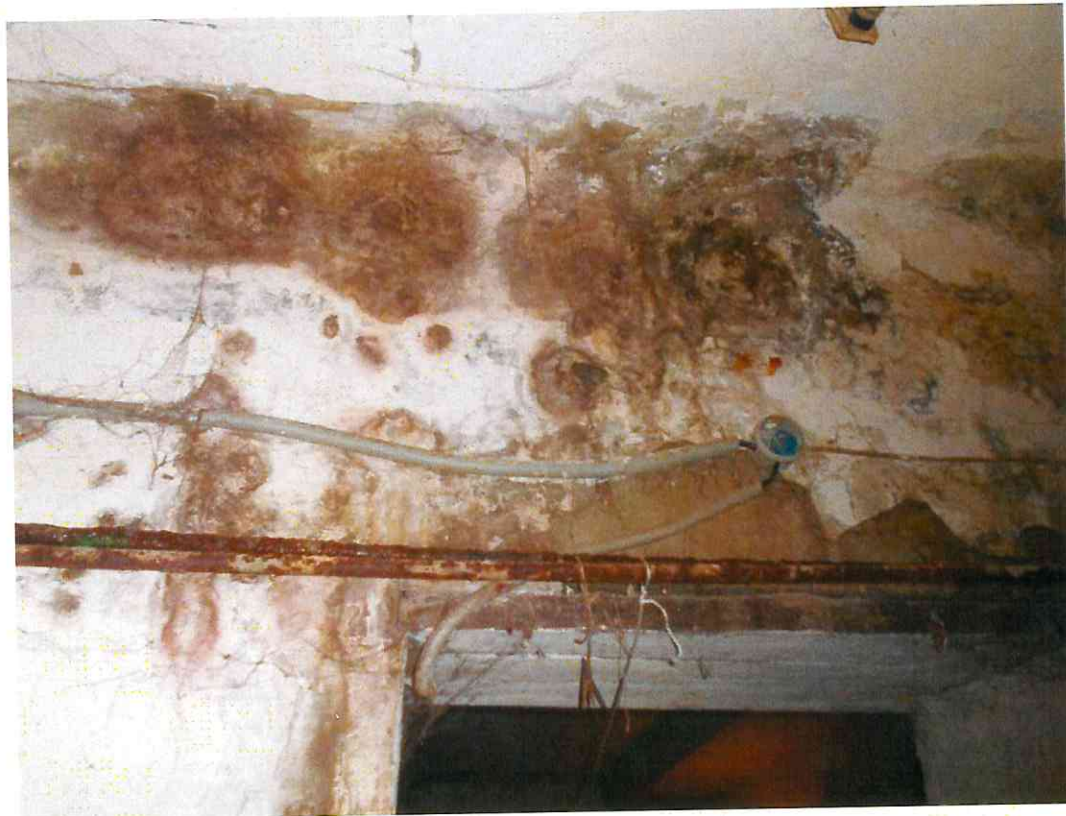
Фото 6. Большая коррозия трубопроводов, неудовлетворительное состояние системы электроснабжения
