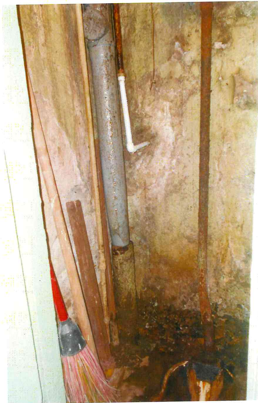
Фото 5. Повреждение эмалированного покрытия чаш Генуя, повреждение чугунных трубопроводов
